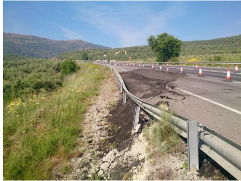
Figura1 Parte de la zona deslizando que afecta a la carretera comarcal A-318.
